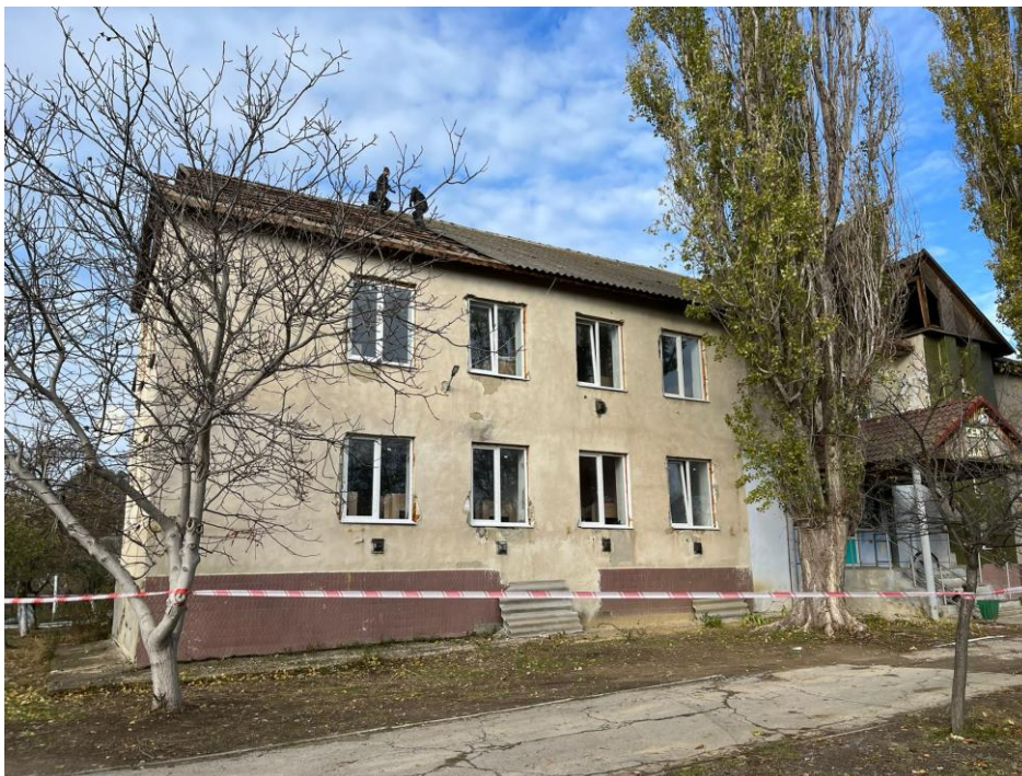
Das House of Hope vor der Renovierung des Daches
