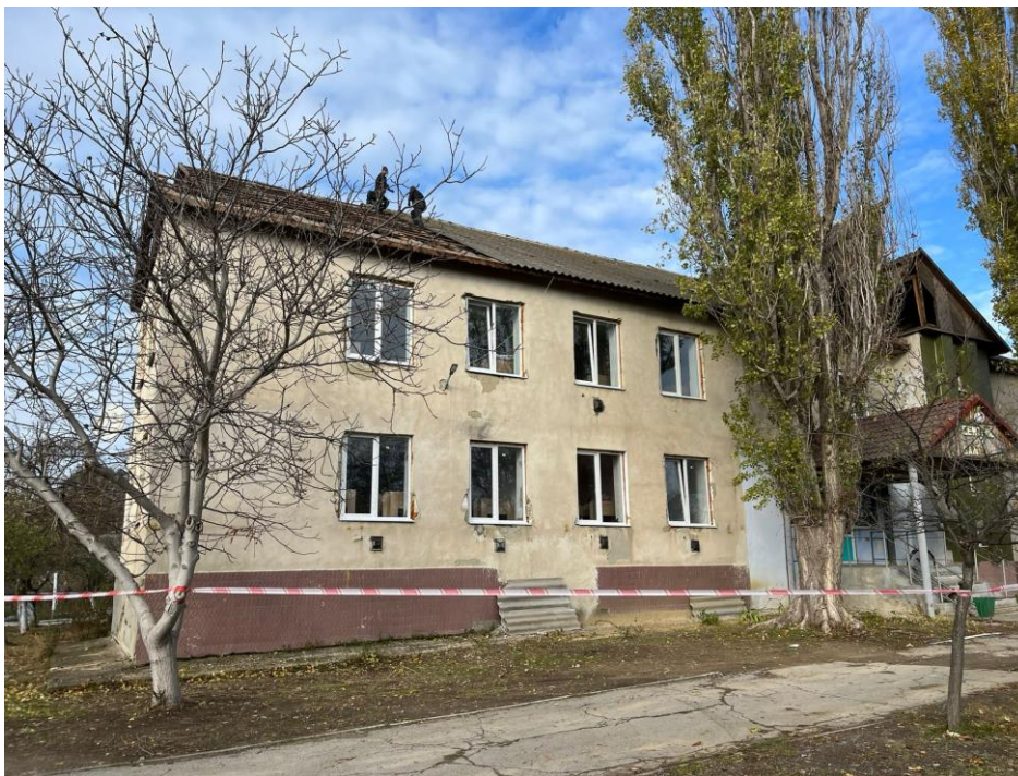
Das House of Hope vor der Renovierung des Daches
